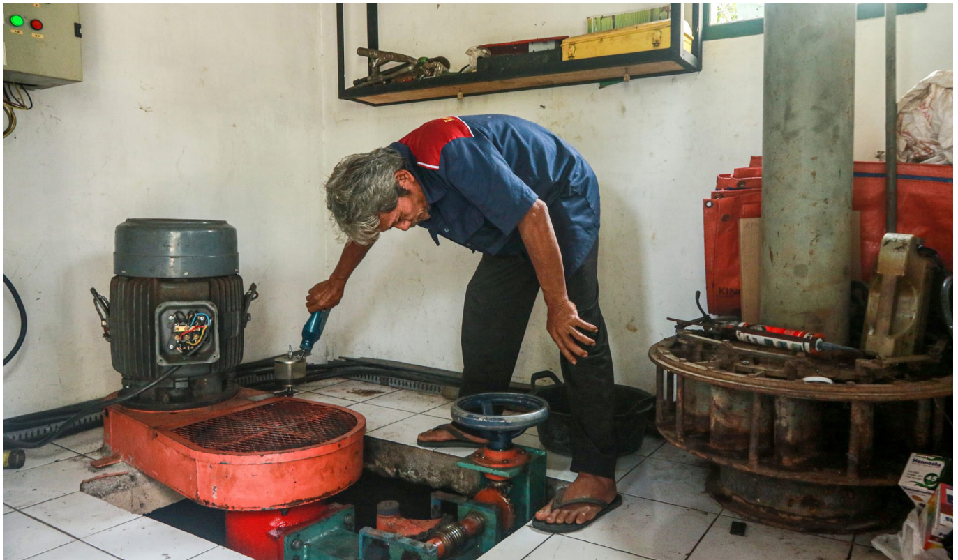
Teknisi melakukan perawatan mesin Pembangkit Listrik Tenaga Mikrohidro (PLTMH) Kedungrong di Samigaluh, Kulon Progo, DI Yogyakarta, Kamis (25/6/2026). ANTARA FOTO/Rahid Putra Laksana
